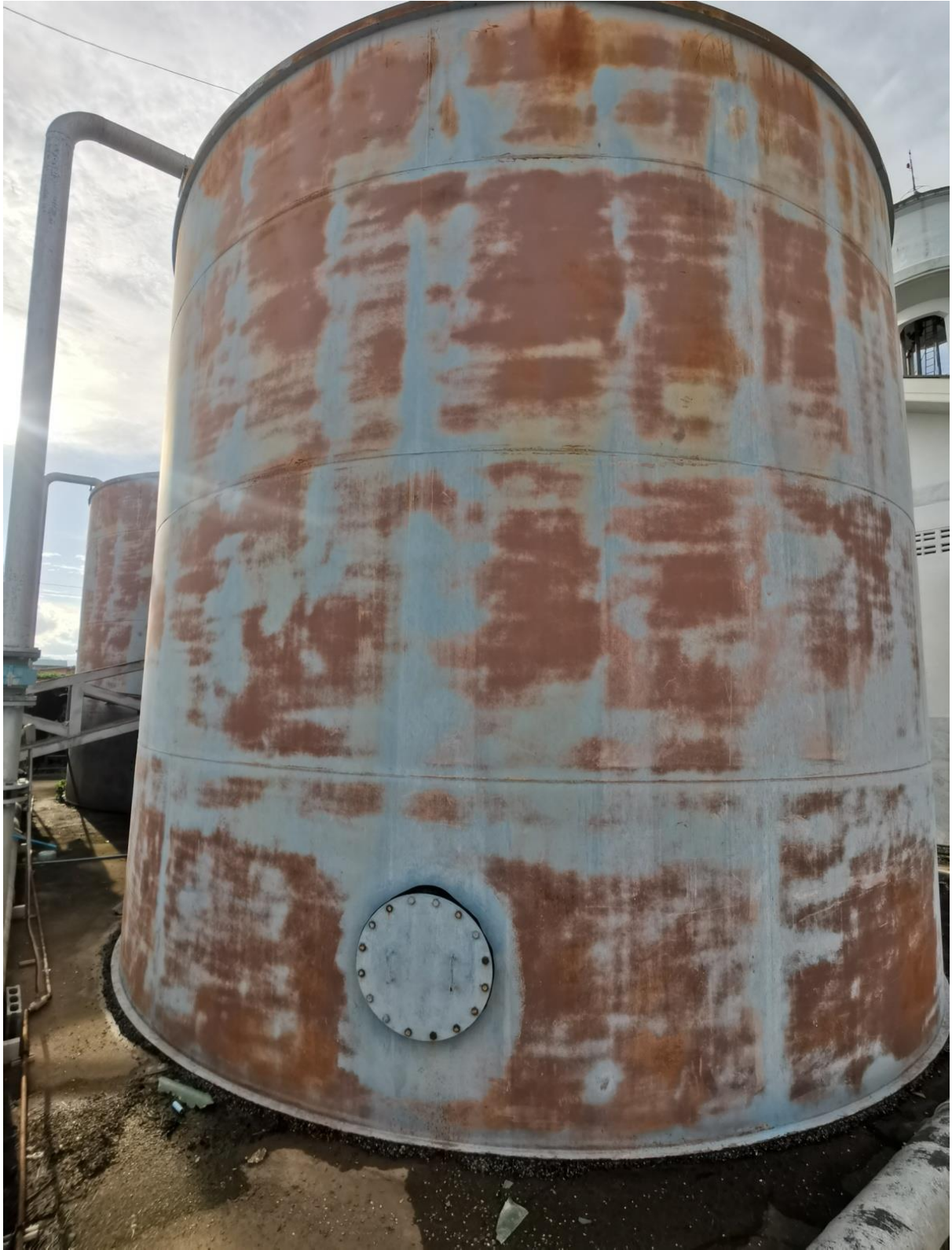
ภาพถ่ายภายนอกของถังตกตะกอน ของระบบประปา
