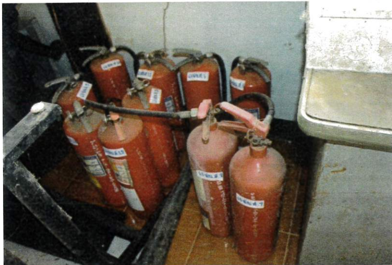
๑๔. เครื่องดับเพลิง ๑๐ เครื่อง
