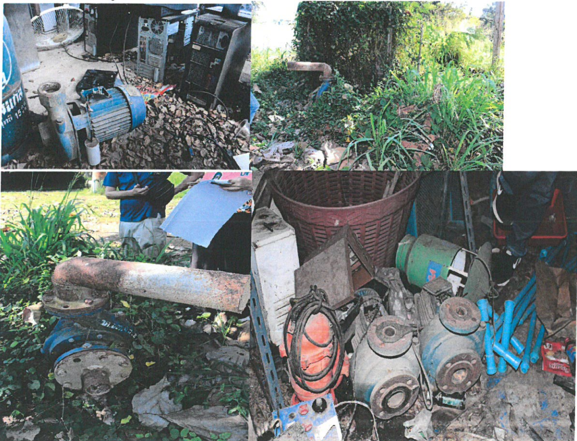
๑๖. ปั้มน้ำ/เครื่องสูบน้ำ ๕ เครื่อง
